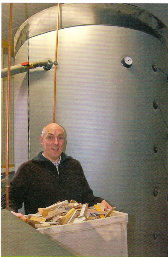
Tischlermeister Matthias Sieg vor dem Warmwasserspeicher seines Holzheizkessels. Hier können die Tischlereiabfälle nutzbringend verbrannt werden.
